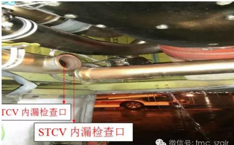
图四 内漏详细检查方法
